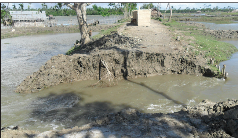
Foto 4: Während des Wirbelsturms Aila 2009 gebrochener, bis 2015 nicht wiederhergestellter Deich
